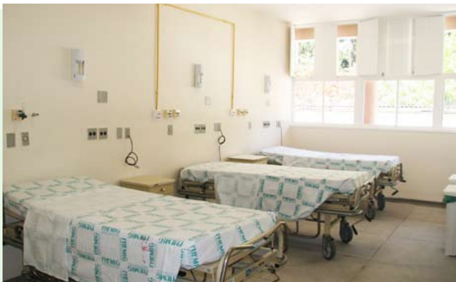
Em cada leito foi implantado um ponto de ar comprimido
